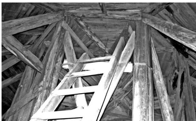
Högt ovanför urverket försvinner ståltrådarna till slaghamrarna upp i tornet.
