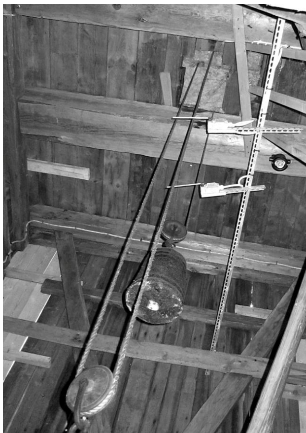
Lodlinorna och avstängningskontakterna för uppdragningen.
